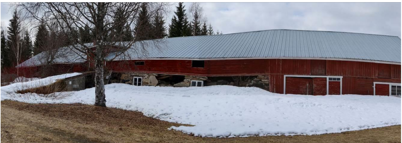
Kuva 12 Iljanan kavinavetta on jo osittain varsin huonossa kunnossa (Kuva: Kimmo Mustonen 5.5.2023)
